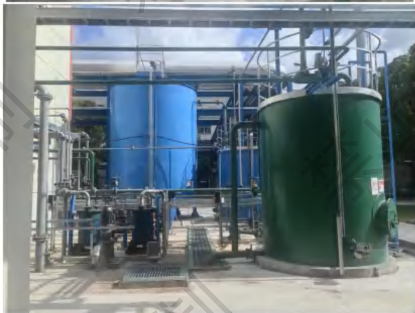
图 4-2 脱硫废水预处理设施
