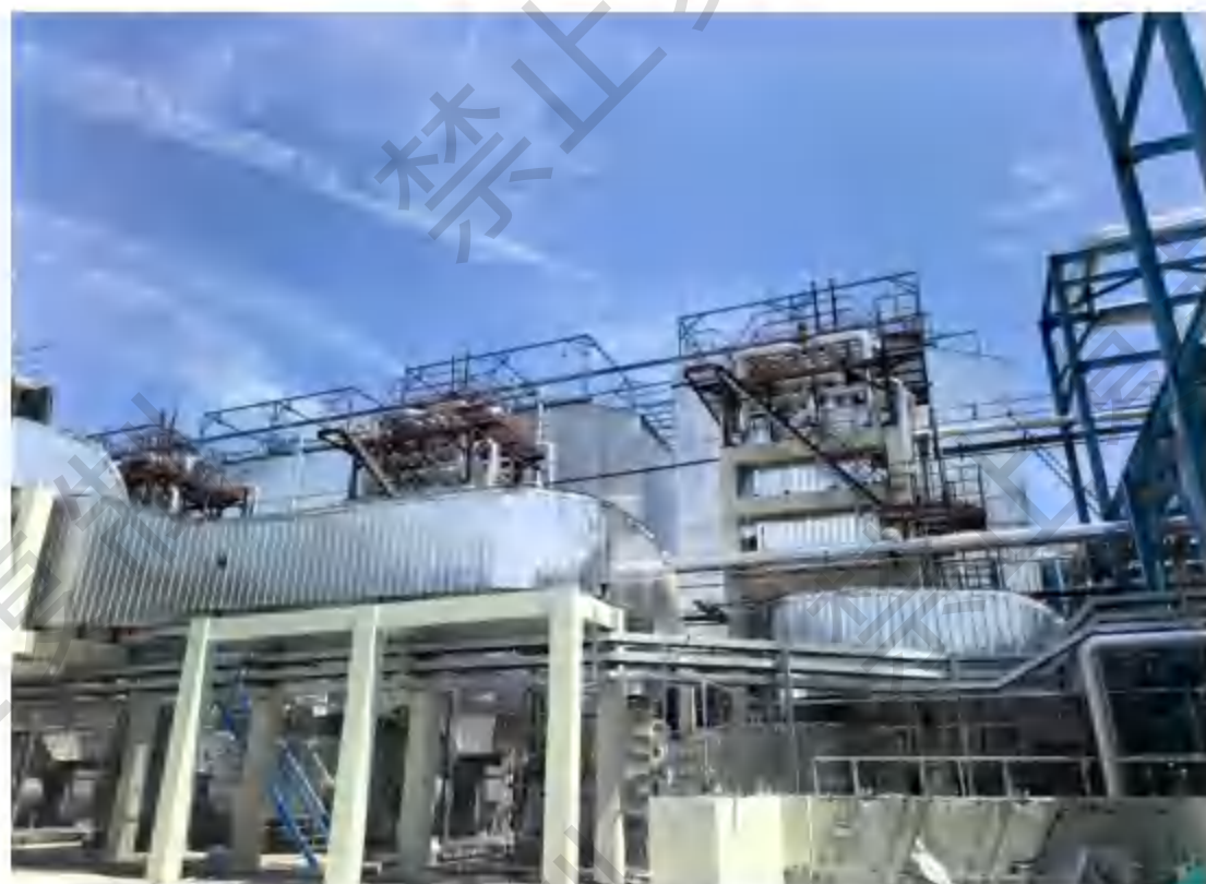
图 4-4 金属滤袋+SCR脱硝装置
