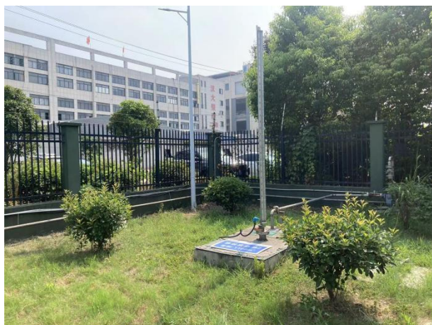
东厂区事故池（地下水池 1100m 3 ）
