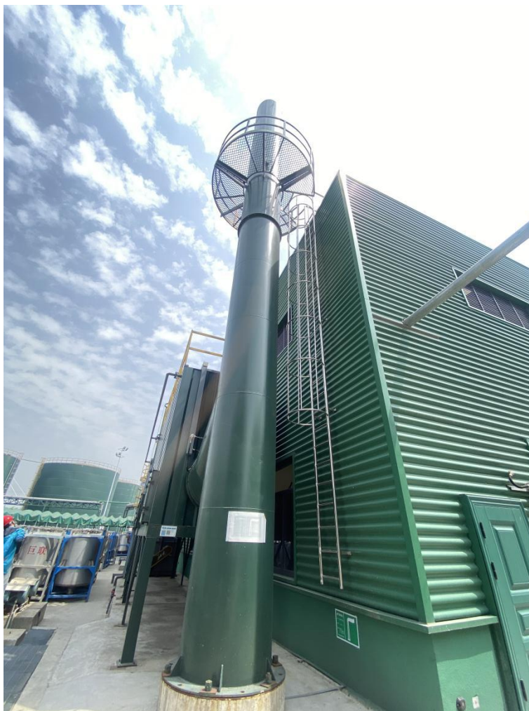
(DA003 排口及标识牌)
